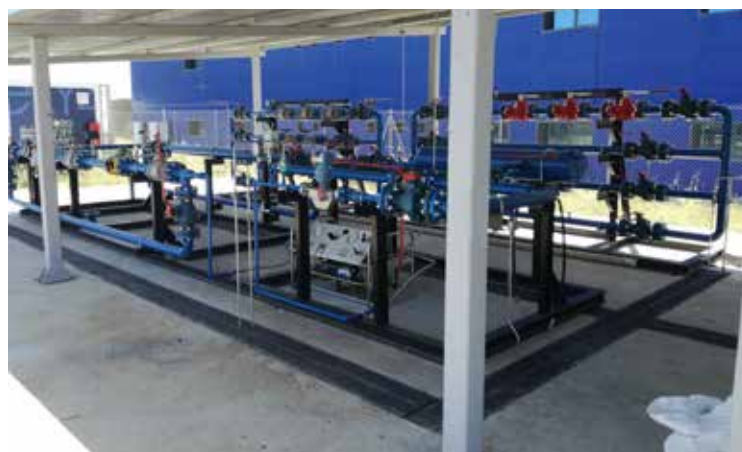
Instalaciones proyecto HIGGS en P.T. Walqa.
